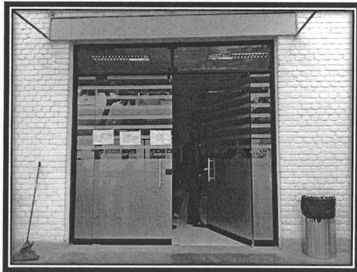
Ruta de evacuación obstruida por puerta cerrada.
