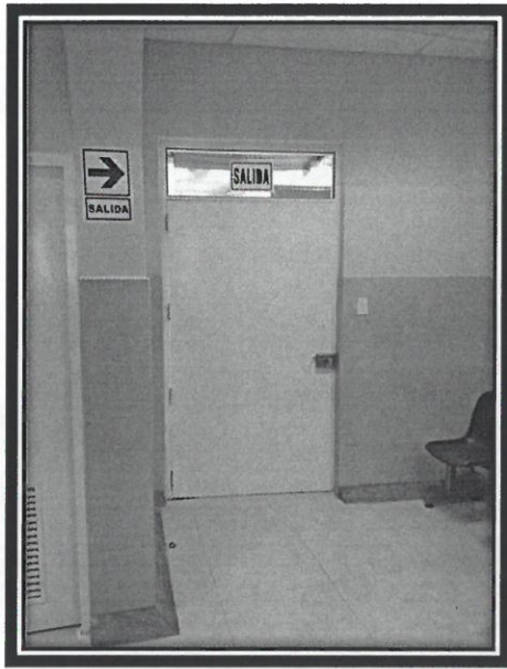
Puerta 02 , ruta de evacuación con puerta cerrada.
