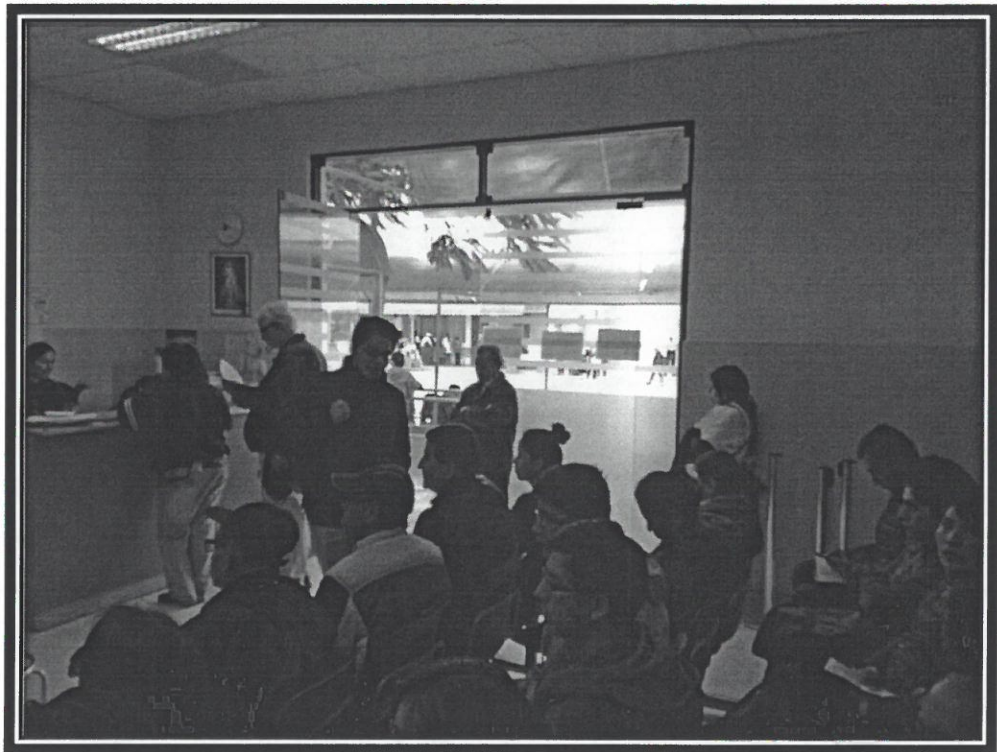
Presencia de gran cantidad de pacientes en espera, puerta de evacuación cerrada en una de sus hojas.
